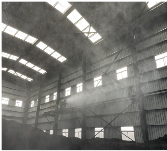
原煤库雾炮抑尘
