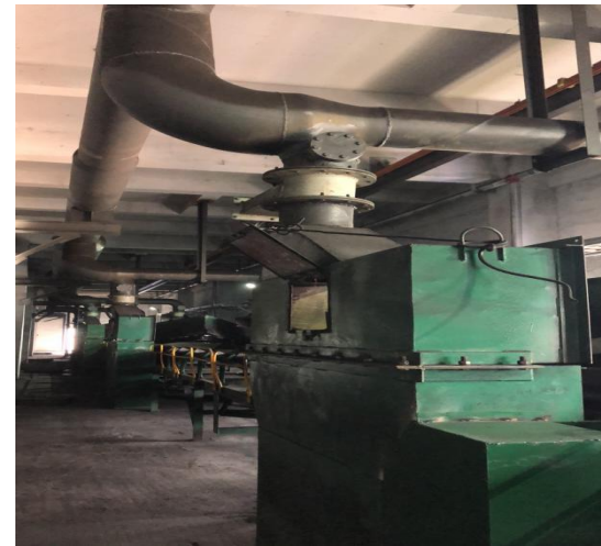
混 2 皮带至 3#造球仓分料器 6#落料口
