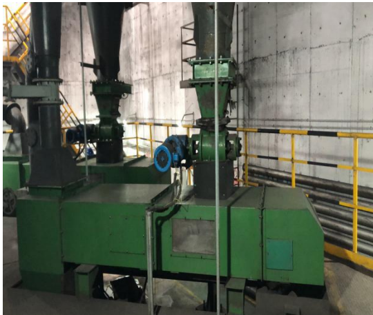
除尘灰仓 1#下料口至 1#除尘灰电子皮带秤
