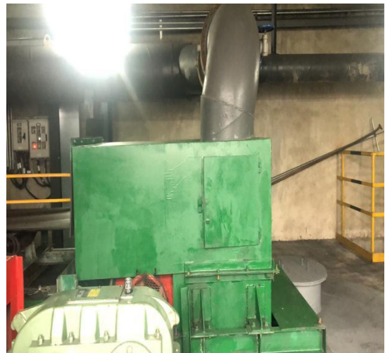
上煤皮带至 2#煤仓
