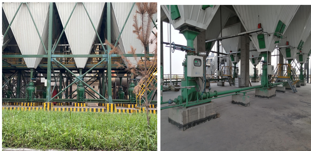
造球链篦机环冷除尘气力输送
